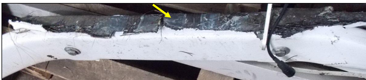
24 – Podwozie główne – zbliżenie na fragment wyrwanego pokrycia kadłuba.
