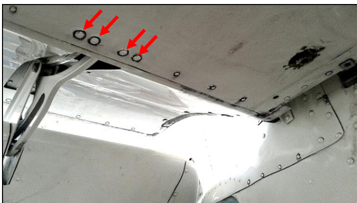
8 – Obluzowane nity na mocowaniu wspornika kłapy do poszycia – strona prawa, zewnętrzna i wewnętrzna.
