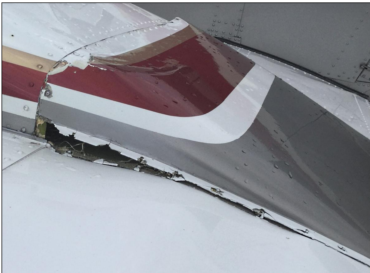
5 – Uszkodzenia tylnej części gondoli lewego silnika – deformacje i oderwanie pokrycia za dźwigarem głównym skrzydła.
