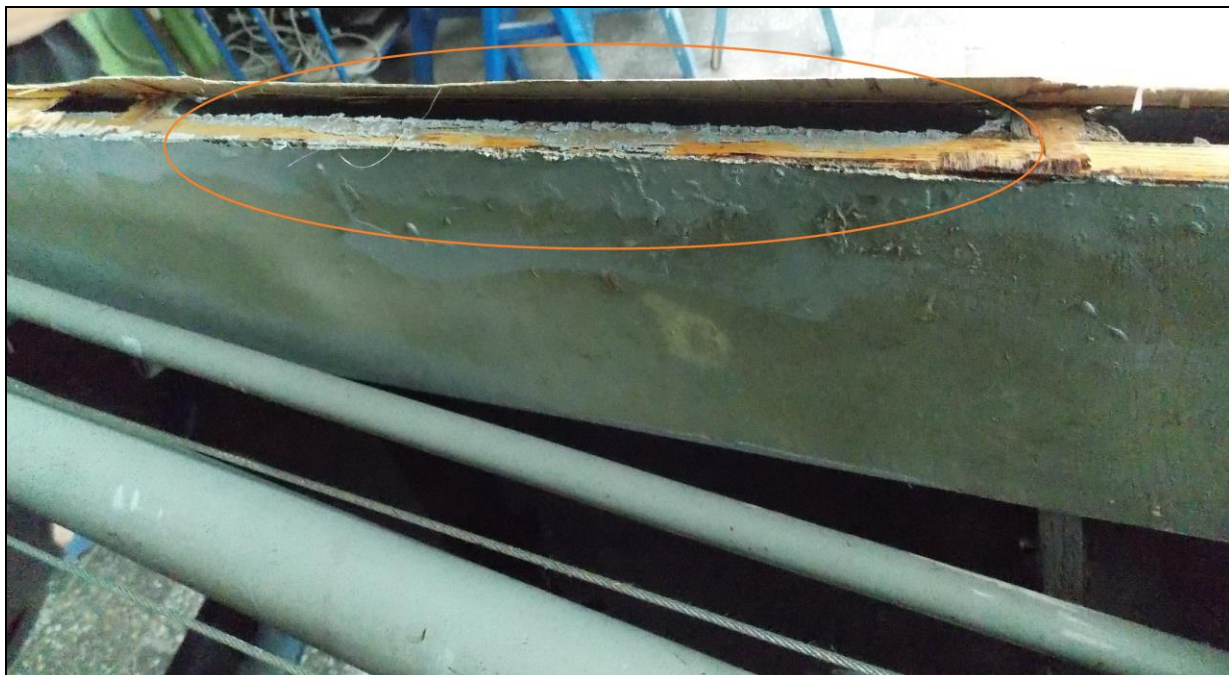
Ilustracja nr 6. Nie doklejenie podłużnicy listwy kilowej.
