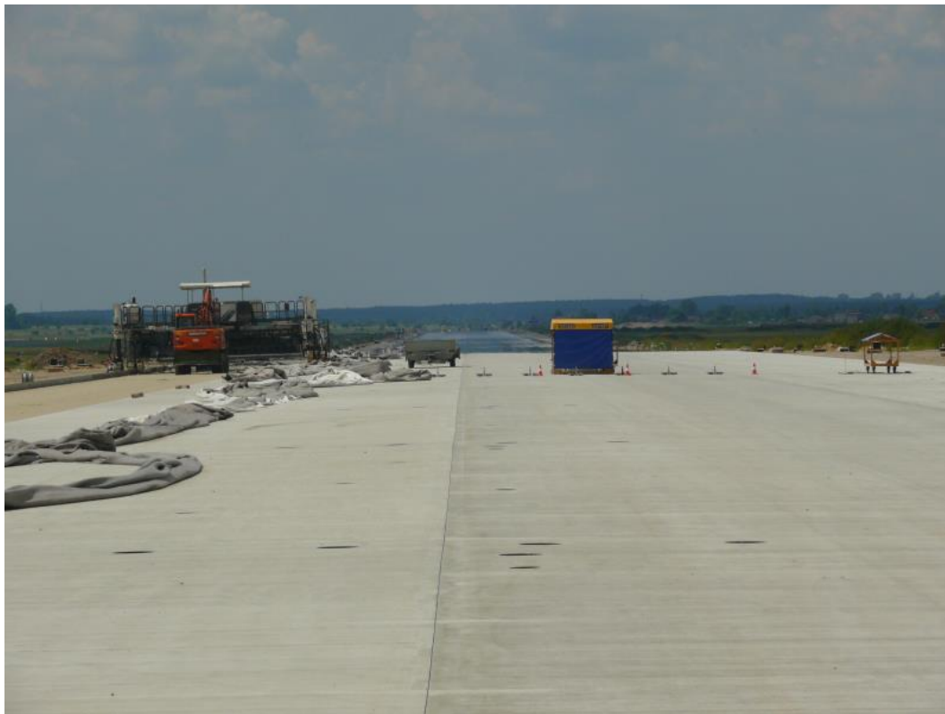
Fot. 6. Sprzęt budowlany na budowanej drodze startowej (~260[m] od początku nawierzchni RWY 27).
