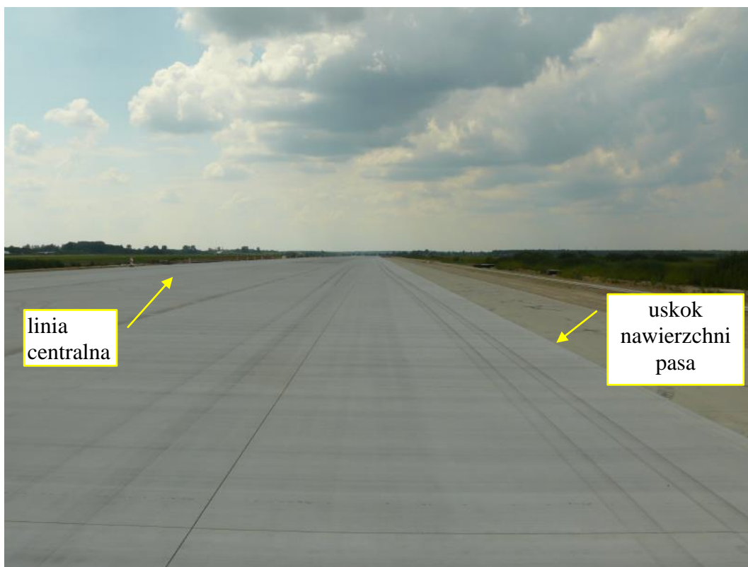
Fot. 9. Ślady maksymalnego zbliżenia się kół samolotu do krawędzi (odległość 1[m] od uskoku) wykonanej nawierzchni drogi startowej.
