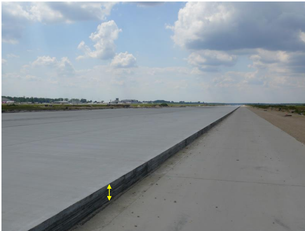
Fot. 10. Uskok nawierzchni budowanej drogi startowej (żółta strzałka wysokość 30[cm], prawa strona).
