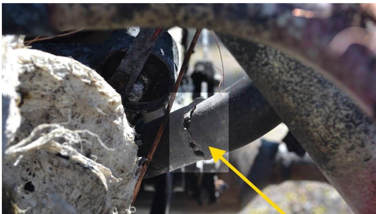
Fot. 3. Zdjęcie ukazuje brakujące elementy spawu, widok od strony zbiornika, fragment rozjaśniono dla większej czytelności. Fot. PKBWL.
