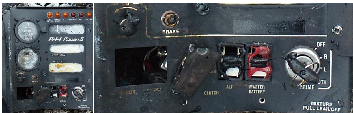
60, 61 – Uszkodzony przez pożar pulpit centralny i jego dolna część z wyłącznikami głównymi i stacją zapłonu (położenie „BOTH” – oba iskrowniki).
