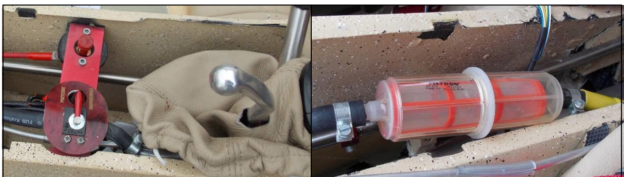
Rys.8. Elementy instalacji paliwowej w kanale pomiędzy fotelami załogi. Po lewej zawór odcinający paliwo, po prawej filtr paliwa.
