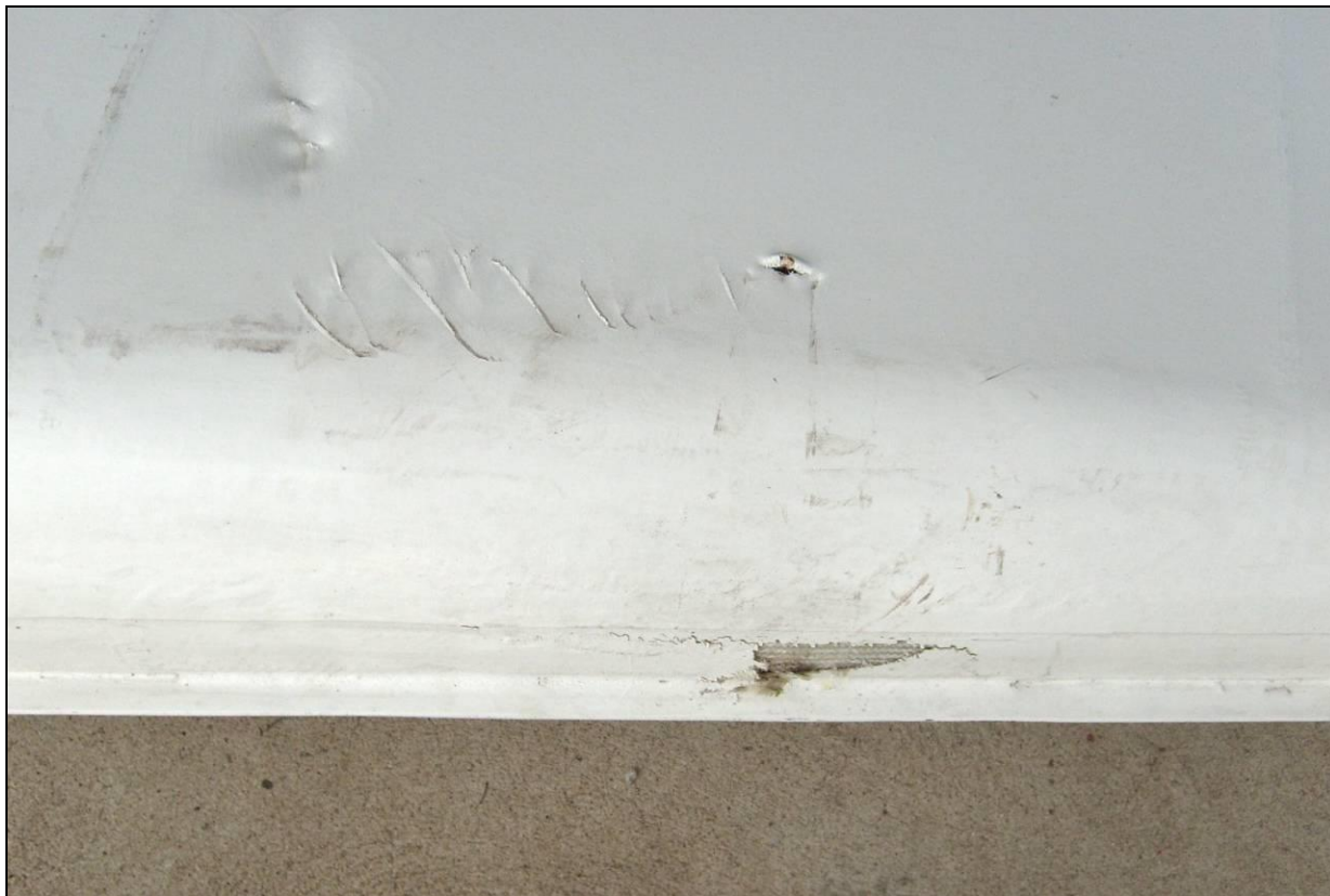
34 – Ster kierunku – uszkodzenie pokrycia z tkaniny przy nosku między zawiasami [PKBWL].
