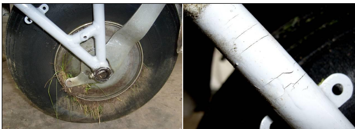
18, 19 – Stan koła i wahacza podwozia głównego – widoczne spękania pokrycia lakierniczego na pręcie kratownicy wahacza mogą świadczyć o wyraźnym odkształceniu lub nawet jego pęknięciu [AWM].
